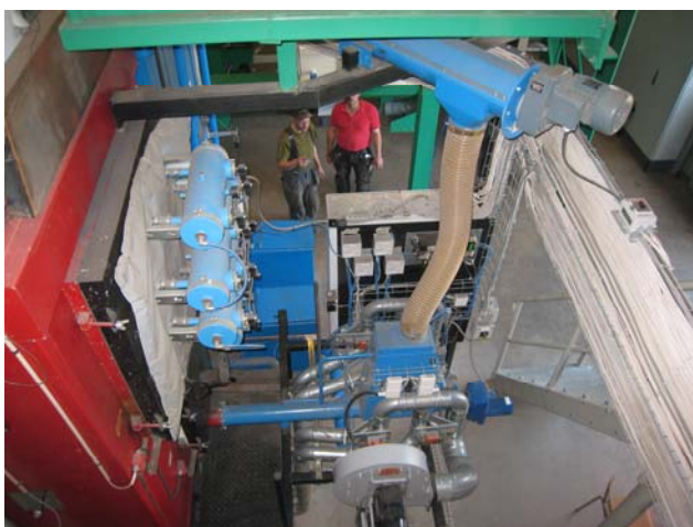
HOTABs BIOAGRO Boiler med automatiskt med automatiskt sotningsystem – vy från första nivåns publikplattform
